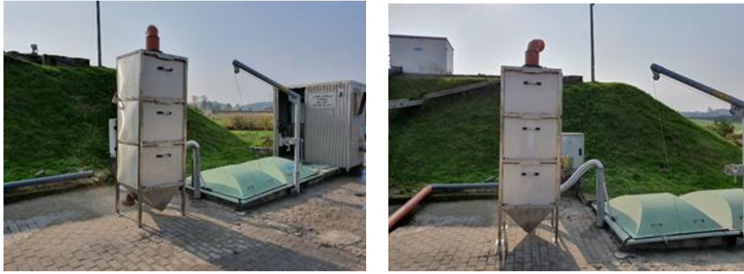
Rys. 1. Urządzenie do oczyszczania strumieni powietrza zainstalowane na terenie oczyszczalni ścieków w Szemudzie
