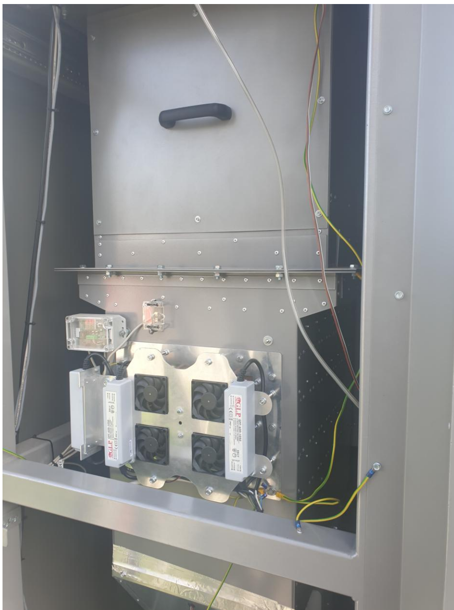
Rys. 11. Wieża fotokatalityczna zlokalizowana na terenie UG: (a) widok zewnętrzny wieży fotokatalitycznej; (b) widok wnętrza wieży fotokatalitycznej.
