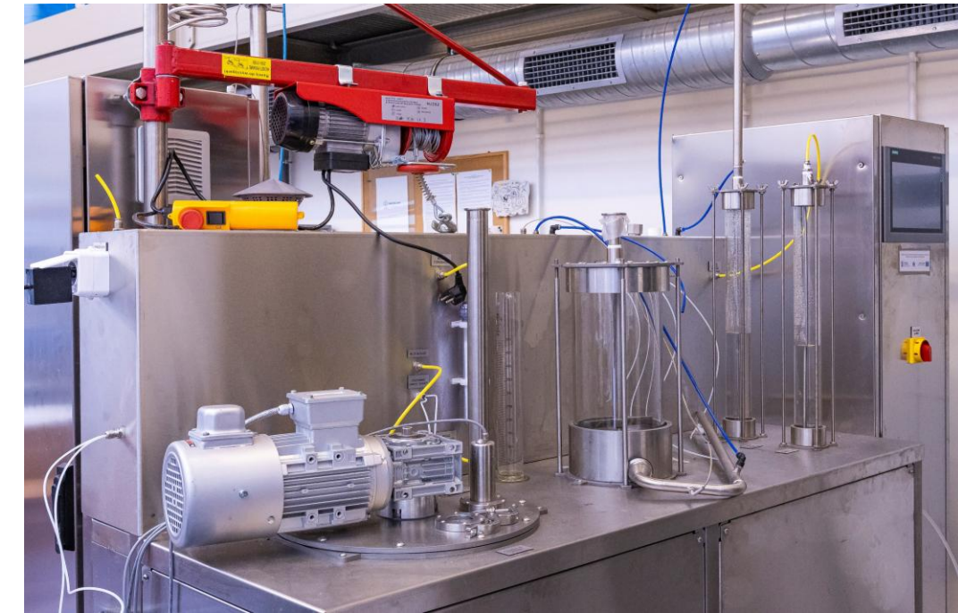
Instalacja do produkcji biogazu
